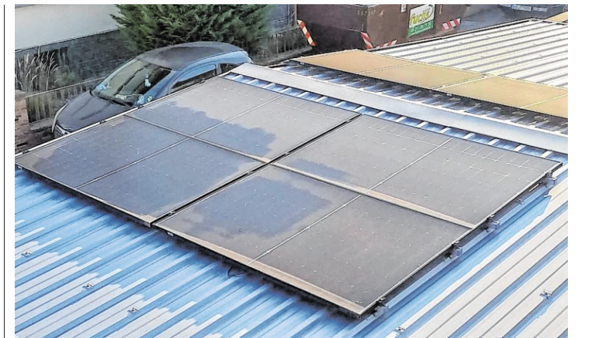
Balkonkraftwerke können sich finanziell lohnen. BILD: MARTIN
